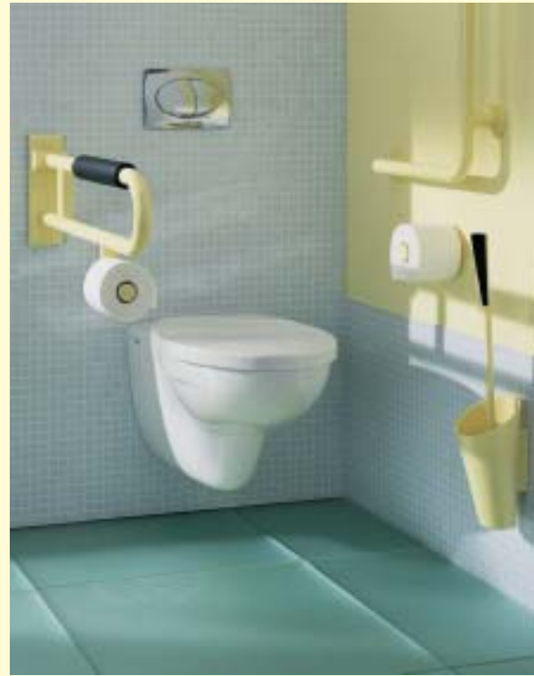
Toiletten- becken mit Haltegriffen
